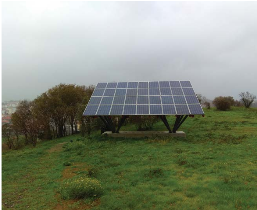
Figura 47. Paneis fotovoltaicos no Monte Gaiás, Santiago de Compostela
