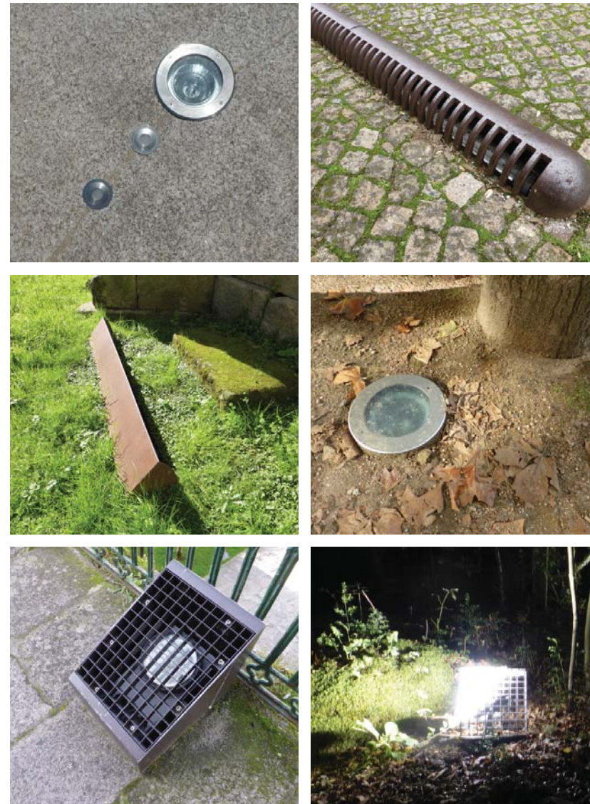
Figura 217. Luminarias de acento
