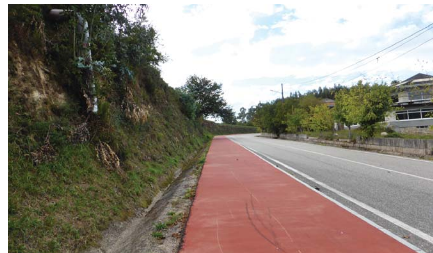
Figura 244. Problemáticas por sección tipicamente urbana de calzada e beirarrúa en contornas naturais ou rurais, con acabados coloreados que non se integran na paisaxe, e ás veces con anchos excesivos que non se axustan á intensidade de uso, obrigando aos peóns a circular en paralelo ao asfalto
