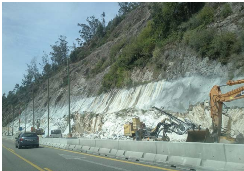
Figura 234. Talude con tratamento gunitado que causa un notable menoscabo estético
