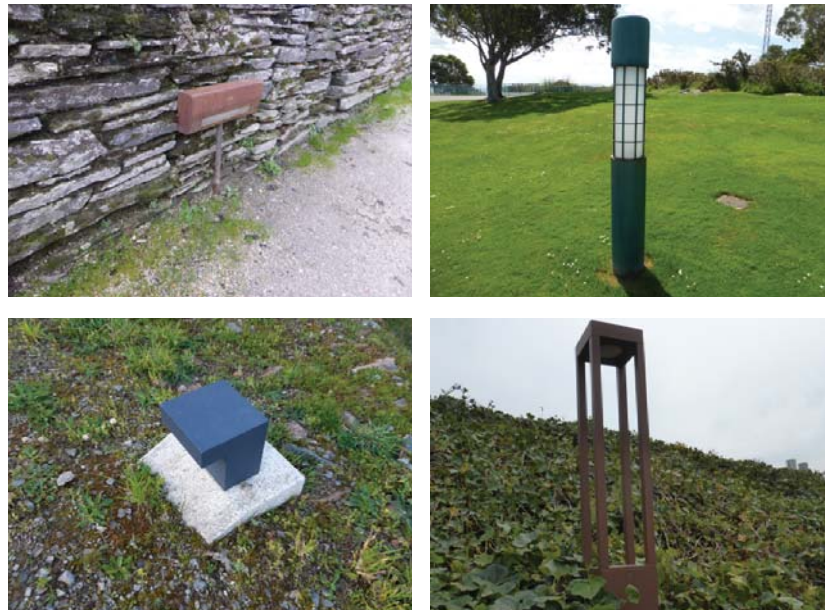
Figura 214. Luminarias medias / baixas
