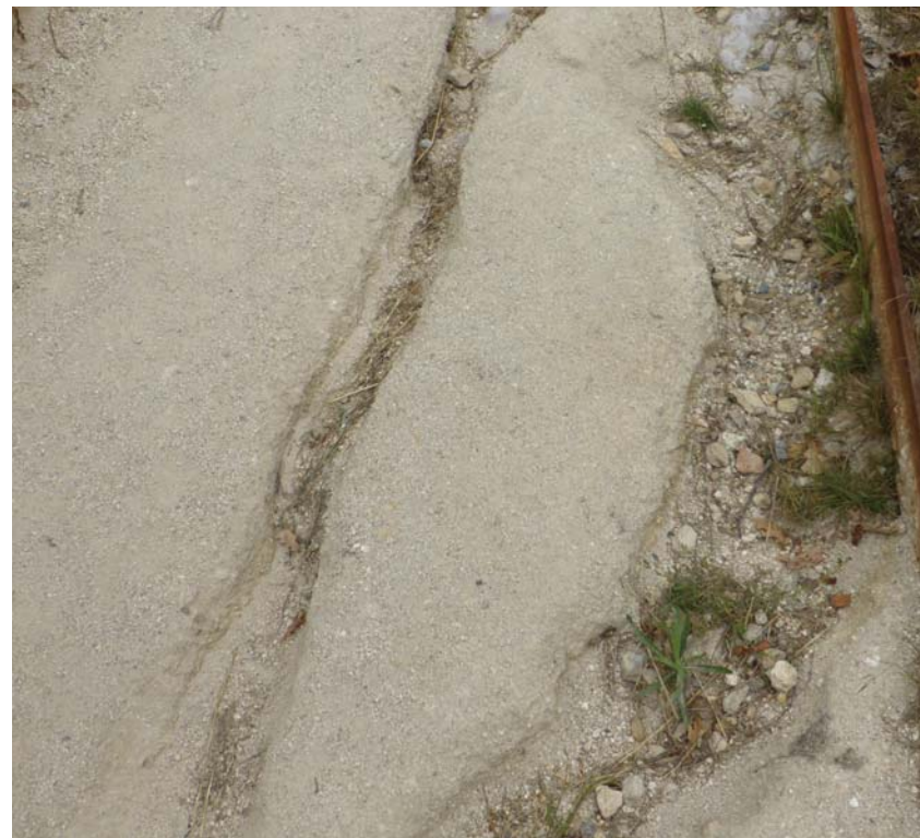
Figura 103. Problemática polo efecto da auga en pavimentos de terra con pendentes elevadas.
