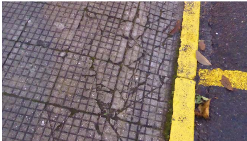
Figura 88. Deterioro característico en pavimento de baldosas hidráulicas polo seu reducido espesor
