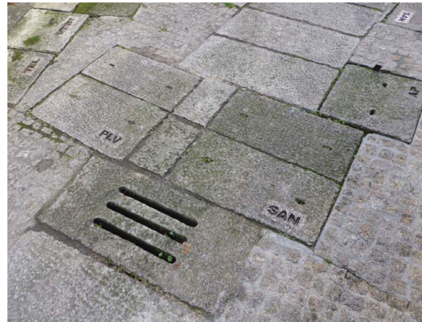
Figura 169. Arquetas e sumidoiro integrados en Pazos de Arenteiro, Boborás
