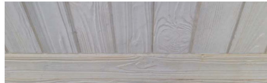
Figura 122. Desaconséllase o emprego de encofrados plásticos imitando madeira
