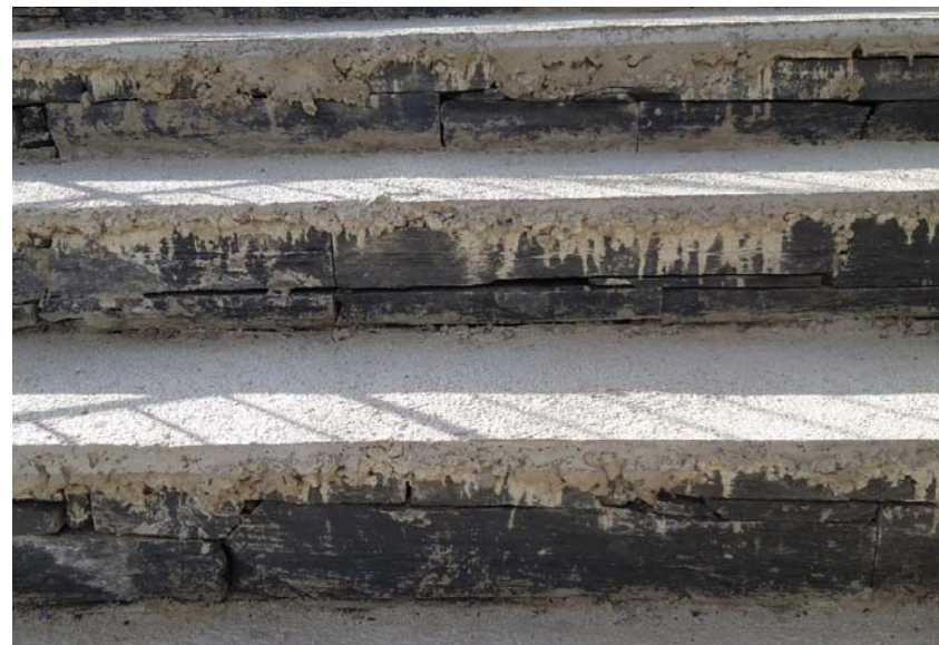
Figura 136. Problemática por mala execución do formigonado en escaleira
