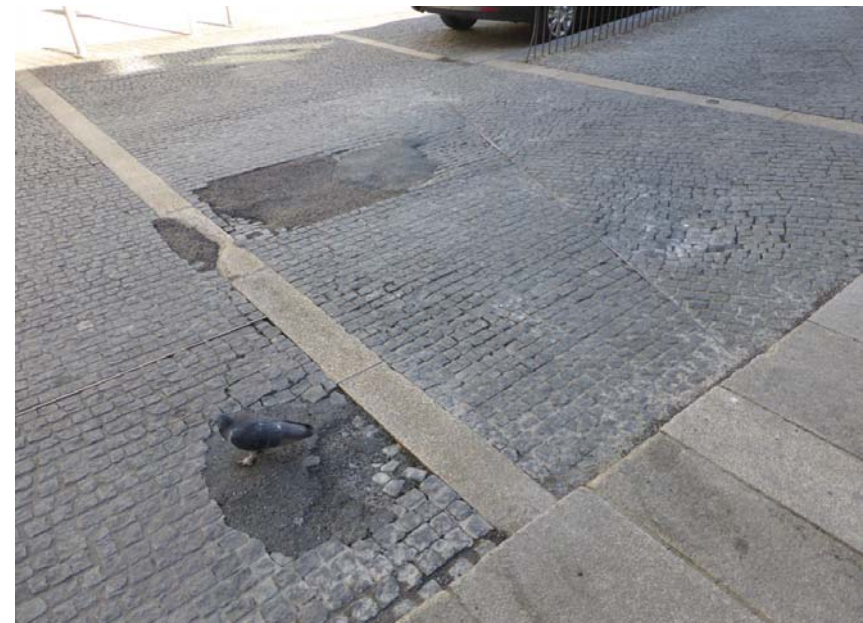
Figura 71. Problemática por mantemento inadecuado que implicou a substitución dos adoquíns por asfalto.
