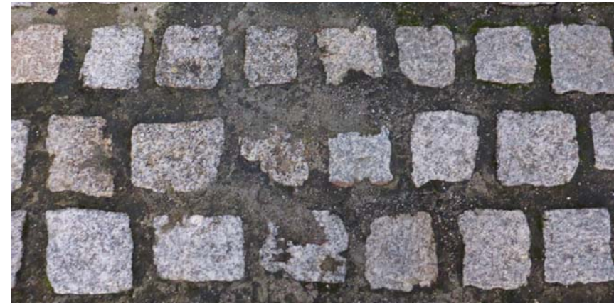
Figura 70. Problemática por xuntas excesivamente grandes con moito recheo de cemento
