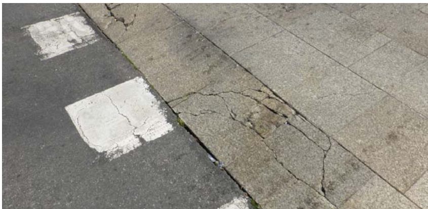
Táboa 8. Deterioro por espesor insuficiente en paso de peóns de pedra, incapaz de absorber o impacto dos vehículos
