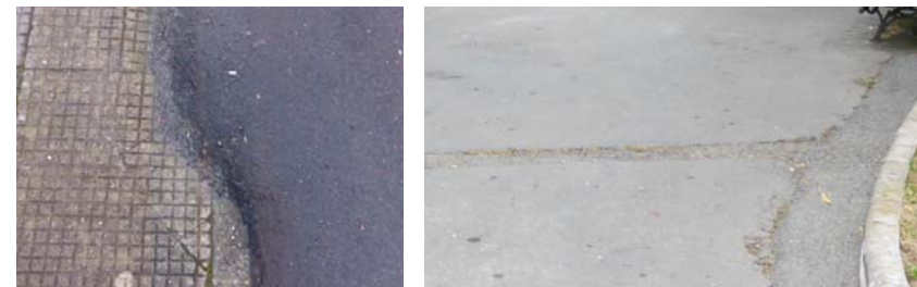
Figura 108. Bordo de asfalto mal executado e parchados no pavimento
